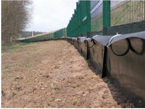
Figure 3 : Clôture imperméable avec système anti-retour
